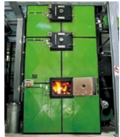
Biomassekessel bei geöffneter Feuerraumtür
